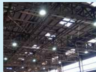
某鋼構造物製作メーカー様
